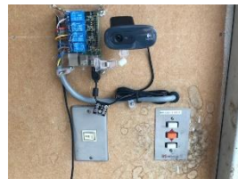
⑨WEBカメラ追加、完成
